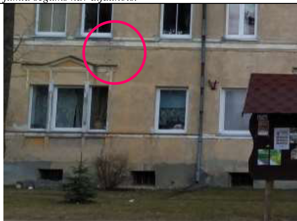
17.att. Apmetuma bojājumi lielākoties ir cokolā un ap logiem. Atsevišķās vietās ir arī plaisas.
