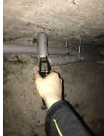
22.att. Vietām siltumapgādes cauruļvadu siltināšanai izmantota neatbilstoša izolācija.
