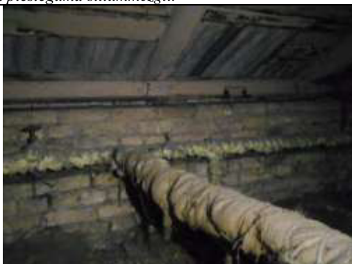
12.att. Ēkas bēniņos esošā cauruļvadu izolācija.
