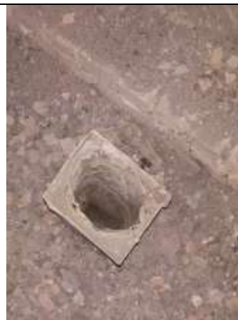
16.att. Bēniņu grīdas siltinājums ir izdedži. Ventilācijas šahtai jāveic tīrīšana.
