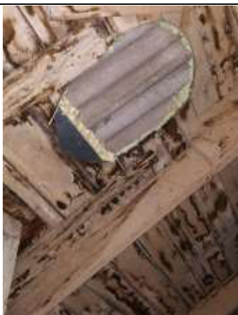
15.att. Obligāti jāveic jumta seguma nomaiņa, jo segums ir novecojis un vietām tek. Papildus ieteicams novērtēt jumta konstrukciju nestspēju. Nedrīkst siltināt bēniņu grīdu pirms jumta segums nav atjaunots.
