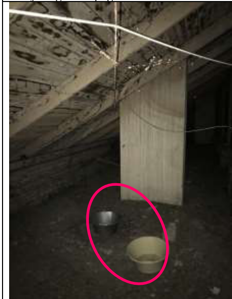
23.att. Ēkai bēniņos salikti spaiņi, vietās, kur bojāts jumta segums. Nepieciešams veikt jumta seguma nomaiņu.
