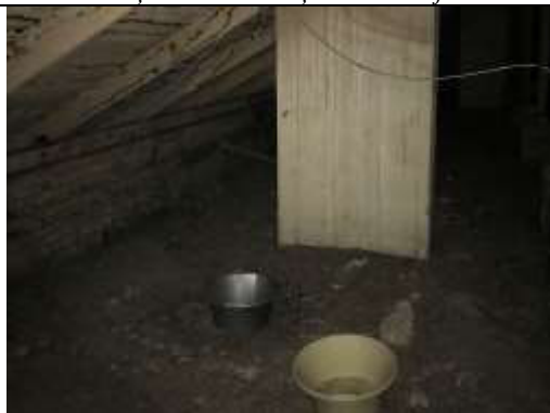
14.att. Ēkas iedzīvotāji ir novietojuši spaiņus bēniņos, jo jumts ir bojāts un ūdens iekļūst iekšā.
